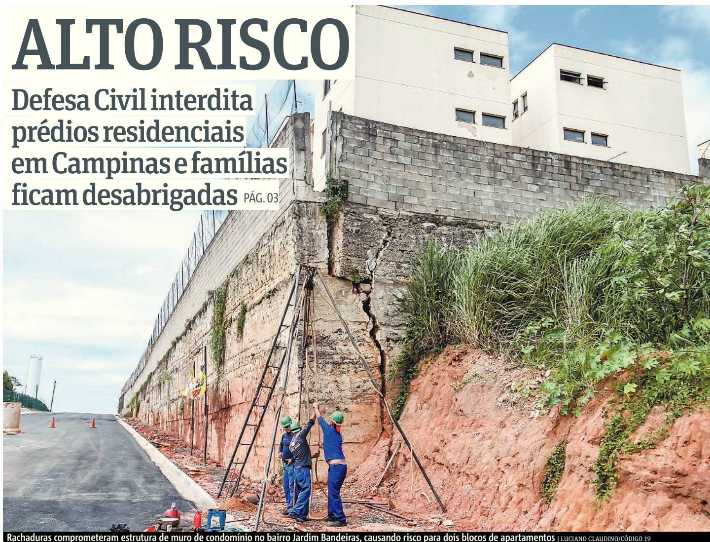
Rachaduras comprometeram estrutura de muro de condomínio no bairro Jardim Bandeiras, causando risco para dois blocos de apartamentos | LUCIANO CLAUDINO/CÓDIGO 19
