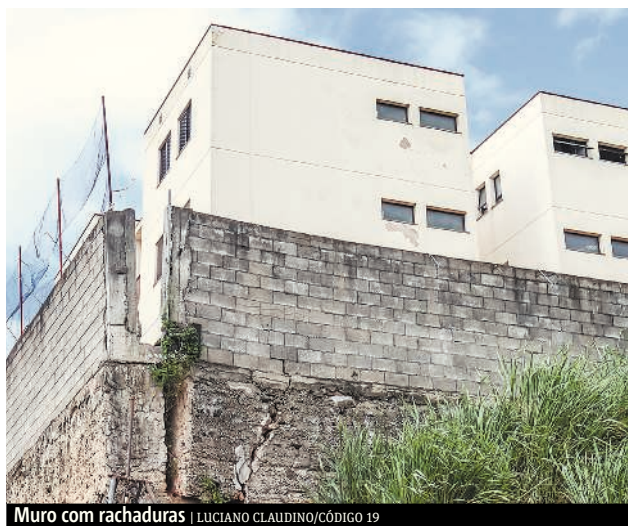
Muro com rachaduras | LUCIANO CLAUDINO/CÓDIGO 19
